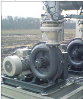
Optimale Förderung des Biogases ist Auslegungssache. Continental Industrie bietet eine fundierte Beratung sowie eine optimale ingenieurtechnische Auslegung für Ihr System.
